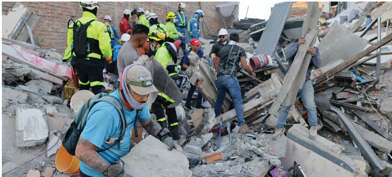
Todos unidos en la búsqueda. Rescatistas, autoridades y ciudadanos remueven escombros en un esfuerzo colectivo por encontrar sobrevivientes y ayudar a las familias afectadas.
